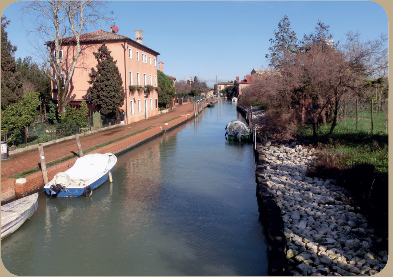
Fig. 3.6,2 - La sponda Est del Canal Maggiore di Torcello in fase di scavo
